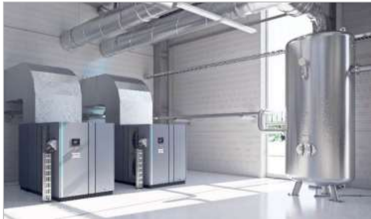
Слика 4 Компресорска станица
