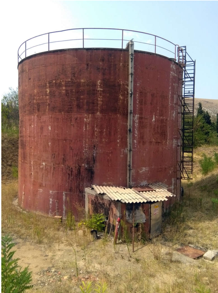
Резервоарот за мазут
