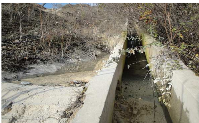
Слика 9. Влез на отпадни води од Инсталацијата во канал за отпадни води од Филтер станица
