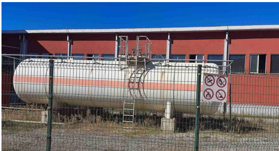
Слика 11 Резервоари за ТНГ
