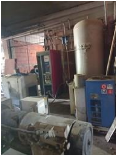
Слика 6 Компресорска станица
