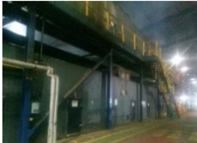
Слика бр. 21: Горна и долна печка и ладилник
