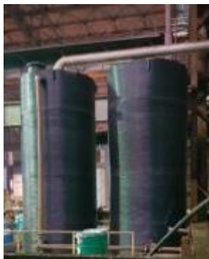
Слика бр. 9: Резервоари за вода за када бр. 5а
