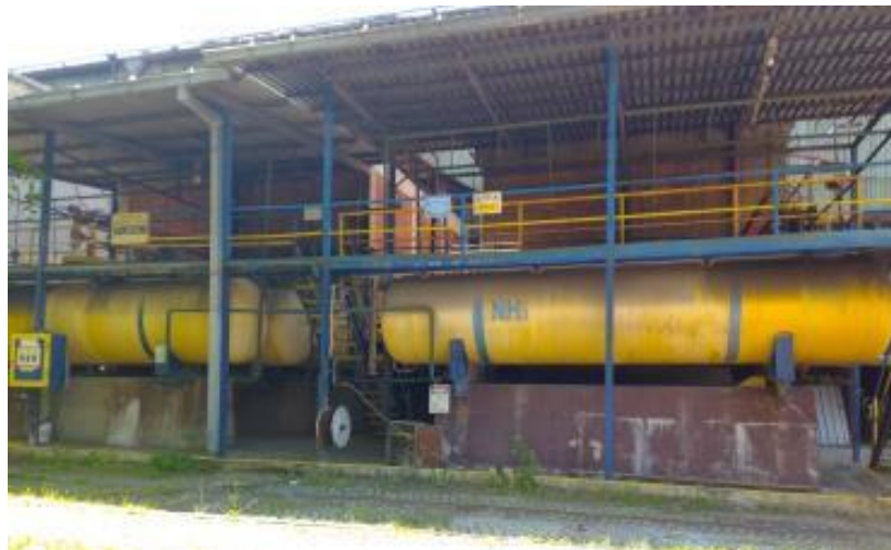
Слика бр. 31: Амонијачна постројка
