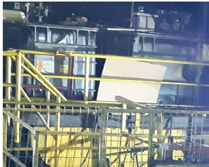
Слика бр. 17: Систем за подготовка на раствор за пасивизација
