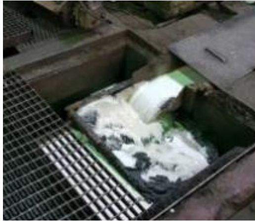
Слика бр. 27: Резервоар за емулзија и канал за емулзија
