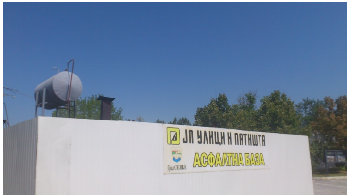
Слика бр. 2: Резервоари за складирање и загревање на битумен
