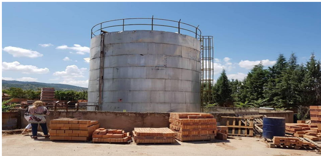
Слика бр. 18 Резервоар за мазут
