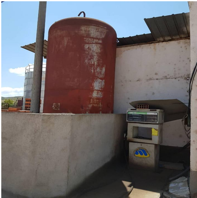
Слика бр. 20 Резервоар за нафта со пумпна станица
