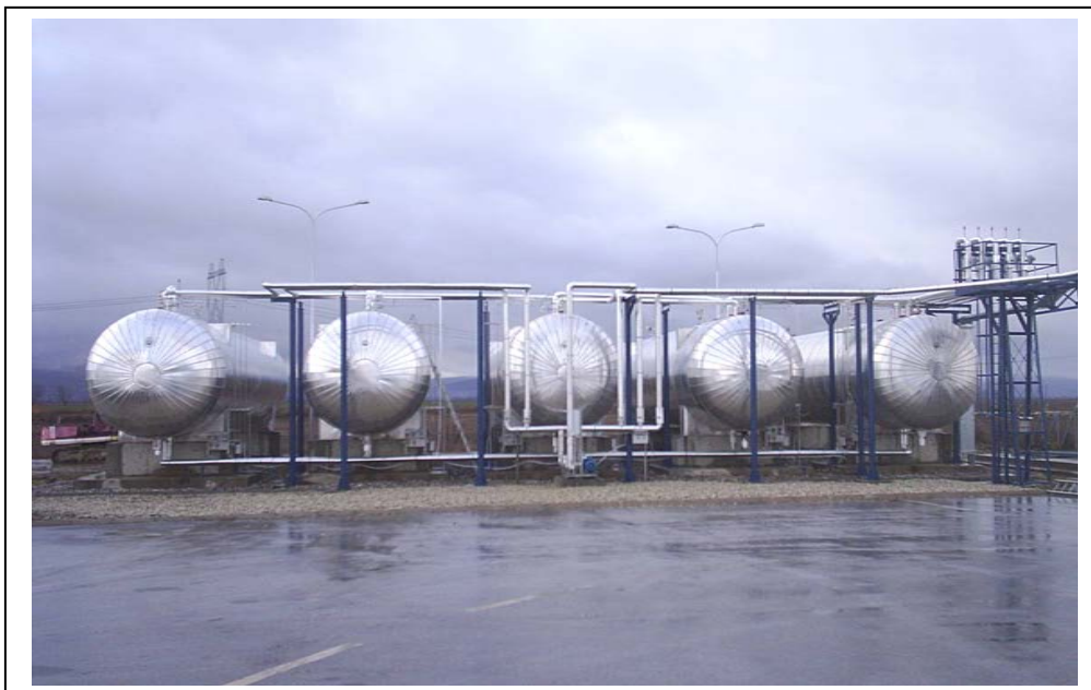
Слика бр. V-5: Резервоари за CO 2
