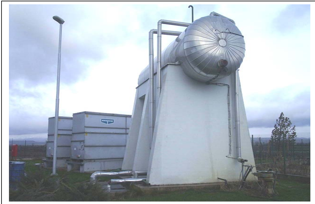
Слика бр. V-8: Ладилни кули со напоен резервоар за разладна вода
