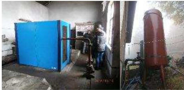
Слика 2 Компресорска станица и резервоари за компримиран воздух
