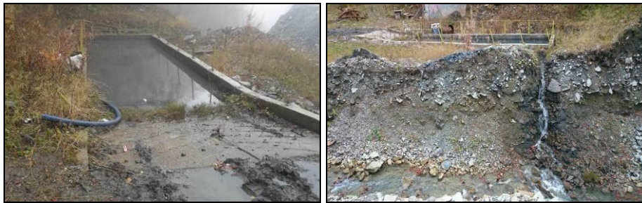
Слика 5 Бетонски канал за усмерување на јамска вода, таложник за јамска вода и испуст од таложник (поткоп II)
