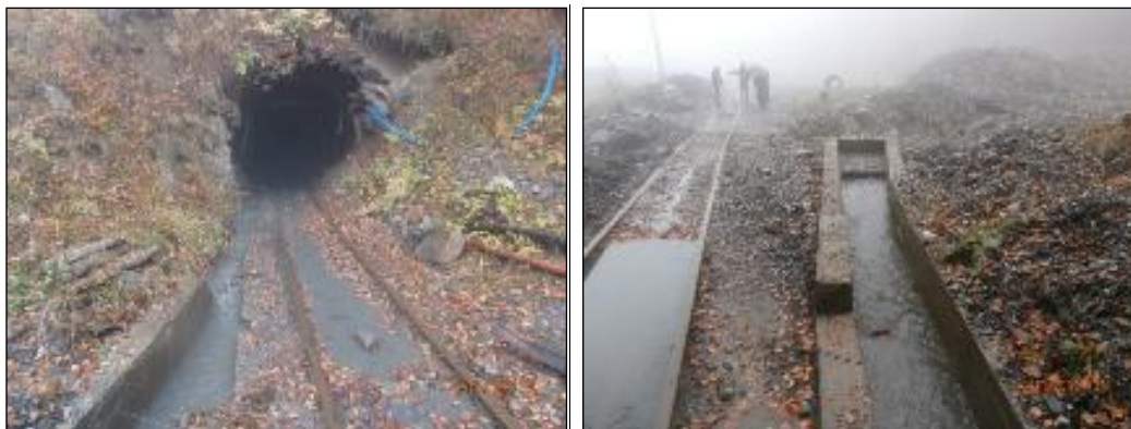
Слика 24 Бетонски канал за зафаќање и усмерување на јамска вода кон таложниците (поткоп II А)
