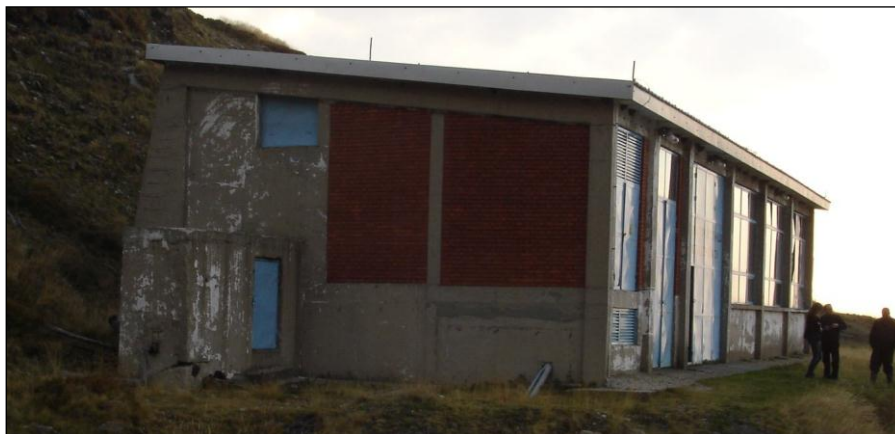
Слика 16 Вентилаторска станица
