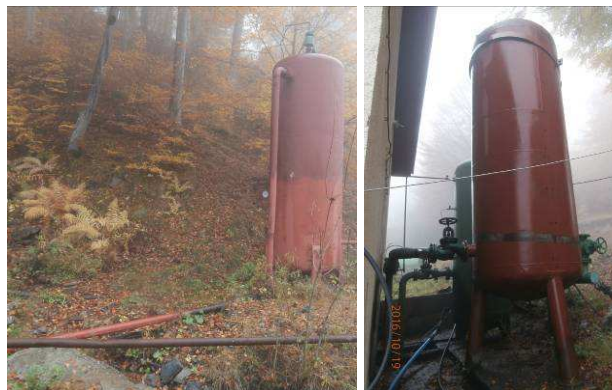
Слика 3 Компресори за компримиран воздух поставен кај поткоп IIа и компресорска станица
