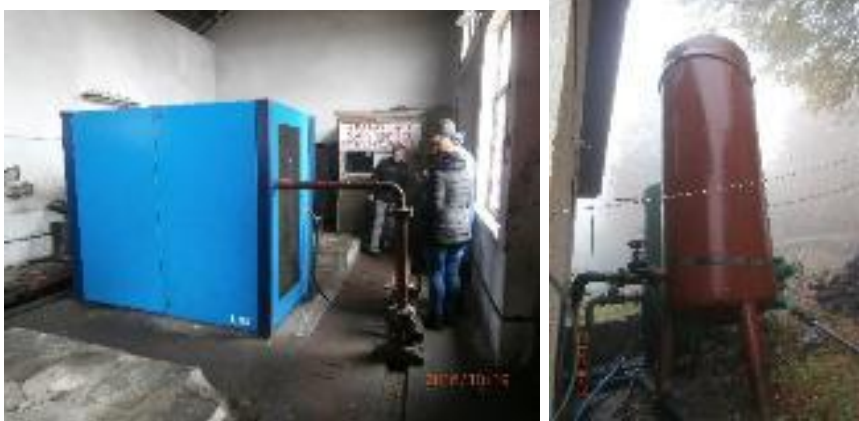
Слика 80 Компресорска станица и резервоари за компримиран воздух
