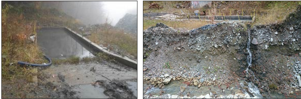
Слика 26 Бетонски канал за усмерување на јамска вода и таложник за јамска вода (поткоп II)
