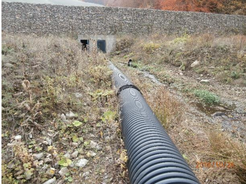
Слика 2 Преливен колектор, кој излегува од куќичката каде се наоѓаат сигурносните вентили. Зад неа е ѕидот од габиони кој придонесува за дополнителна потпора и стабилност на јаловишната брана
