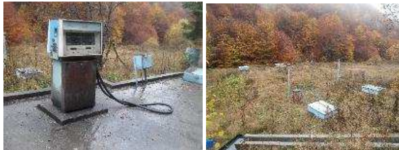
Слика 4 Пумпна станица и подземни резервоари за нафта
