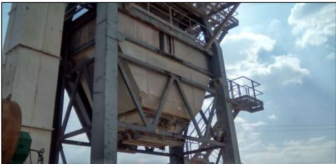
Слика 19. Систем за складирање на готов материјал
