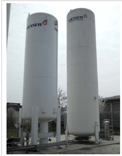
Слика бр. II.2-1: Резервоари за течни гасови
