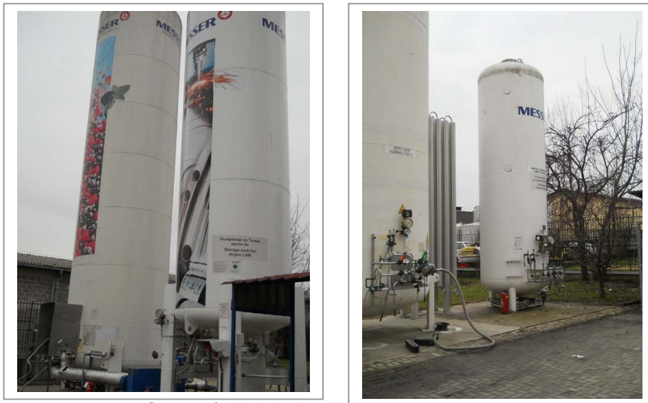
Слика бр.V.1-1: Резервоари за течни гасови
