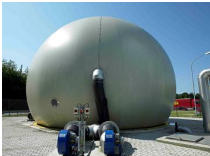
Слика 3-112: Резервоар за складирање на биогаз од ферментаторот за отпад
