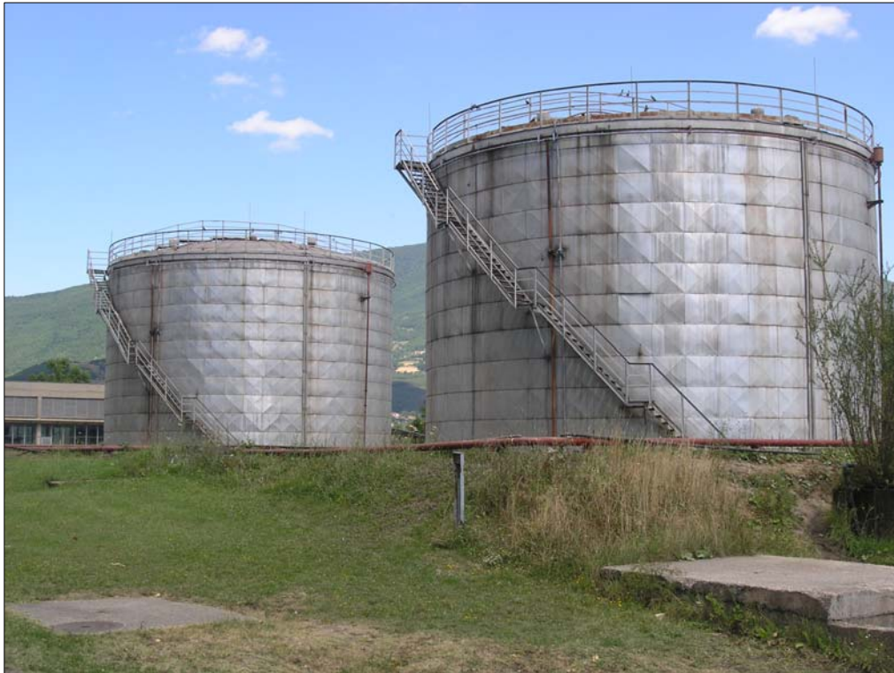
Сл. бр. 8. Резервоари за складирање на мазут
