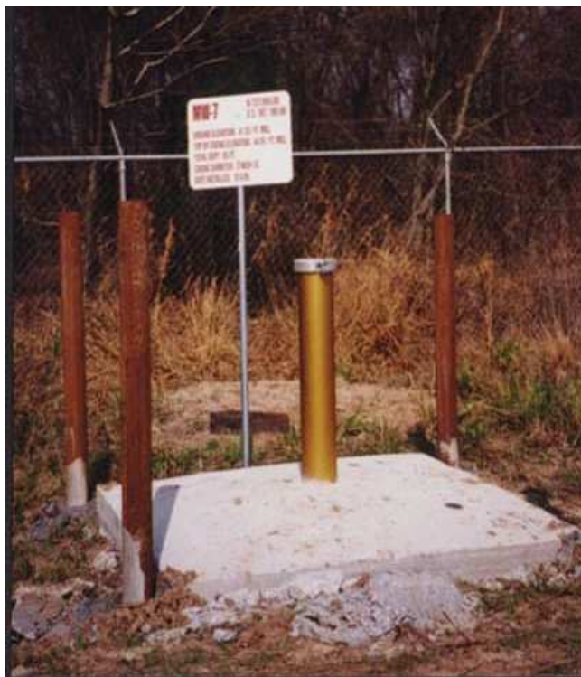
Слика Изглед на пиезометар за следење на подземна вода
