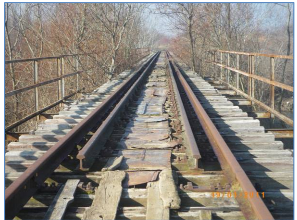
Слика 4 – Мост преку реката Пчиња кој треба повторно да се изгради (КП 24.4)
