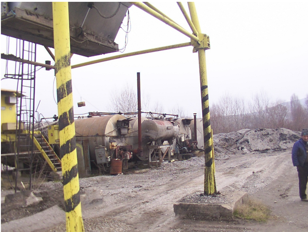
Slika br.2: Cisterni za skaldirawe na mazut i bitumen
