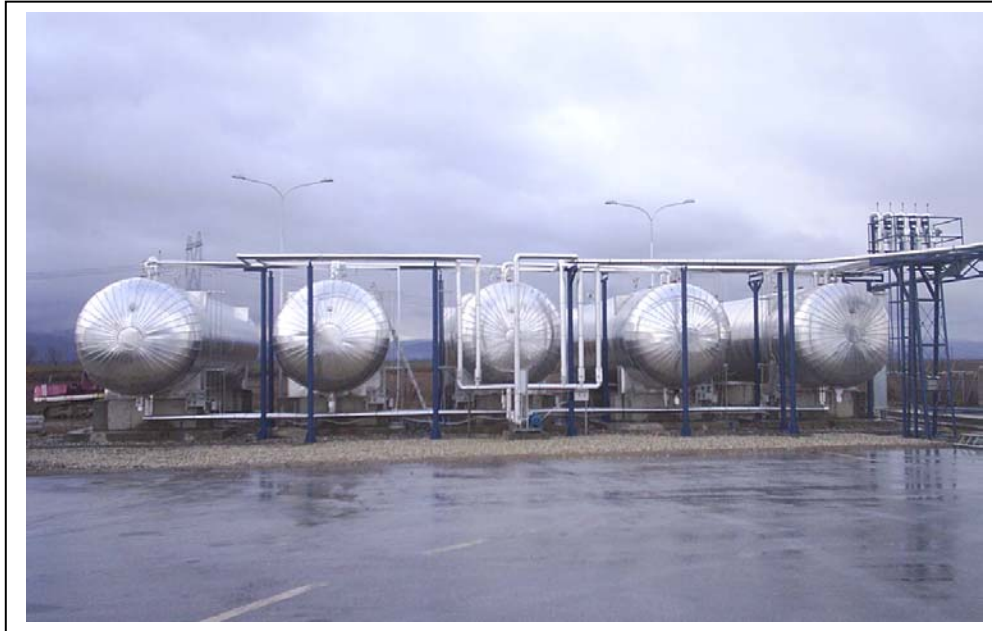
Слика бр. V-5: Резервоари за CO 2
