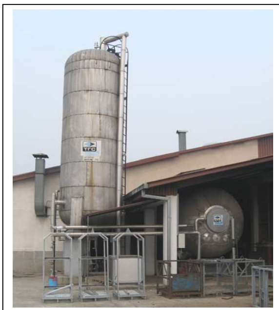
Слика бр. V-3 : Резервоари за CO 2
