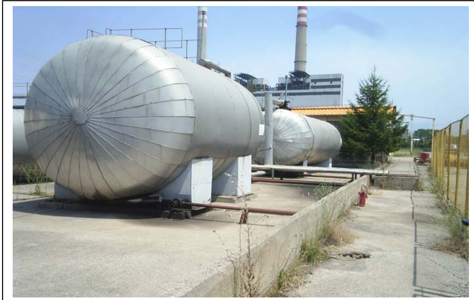
Слика бр. V-6: Резервоари за складирање на масла
