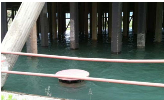
Слика 14: Базен за собирање на оладената вода под ладилната кула
