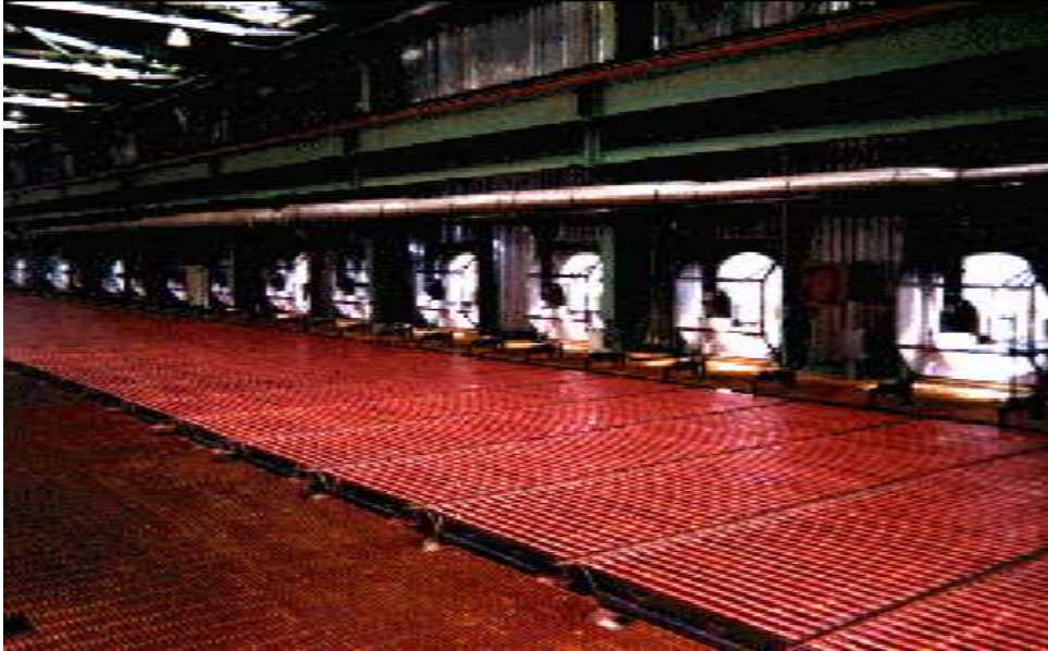
Слика - Локална вентилација кај електролизни кади
