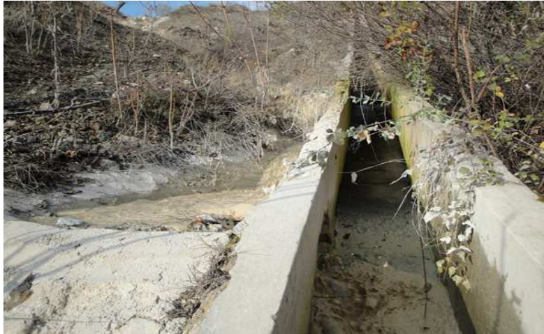
Слика 7. Влез на отпадни води од Инсталацијата во канал за отпадни води од Филтер станица
