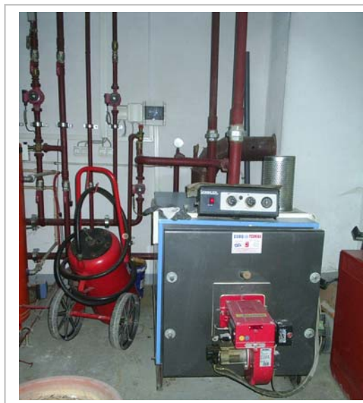
Слика II.2-3: Котел во управна зграда
