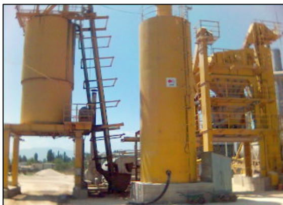
SI.4: Silos za gotov asfalt
