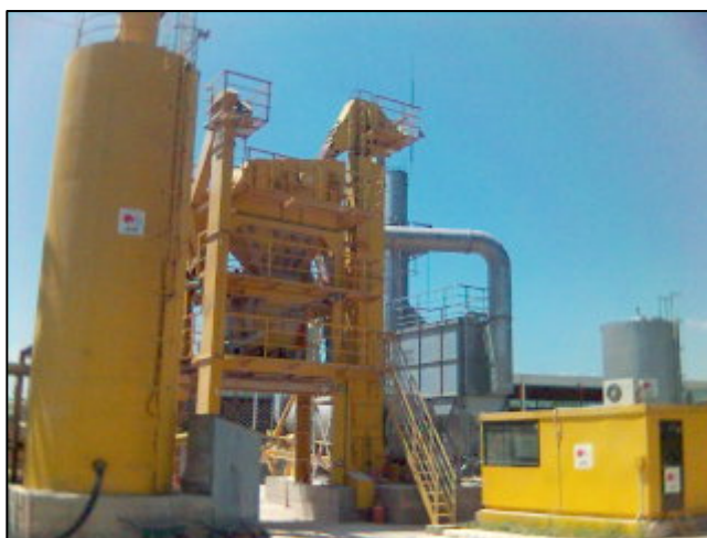
SI.3: Bunker za filer i me{alka za asfalt
