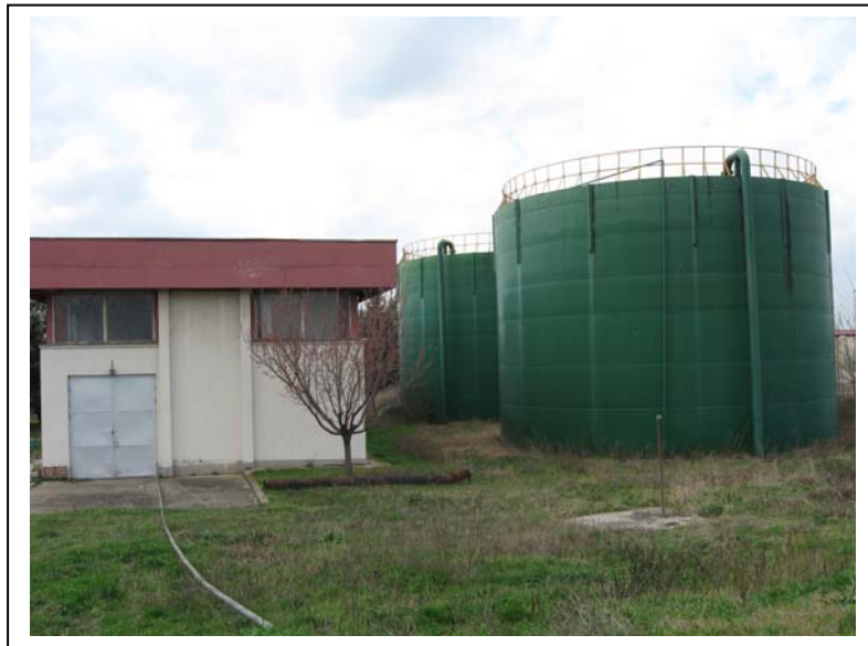
Слика бр. XII-1 : Централна пумпна станица и резервоари за вода
