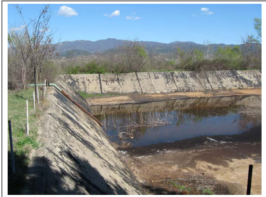
Слика бр. XII-12 : Бетонски базен за хавариски случаи
