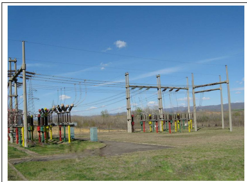
Слика бр.П-25 : Разводна постројка
