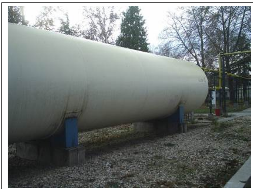
Слика бр.V-4 : Резервоар за O 2
