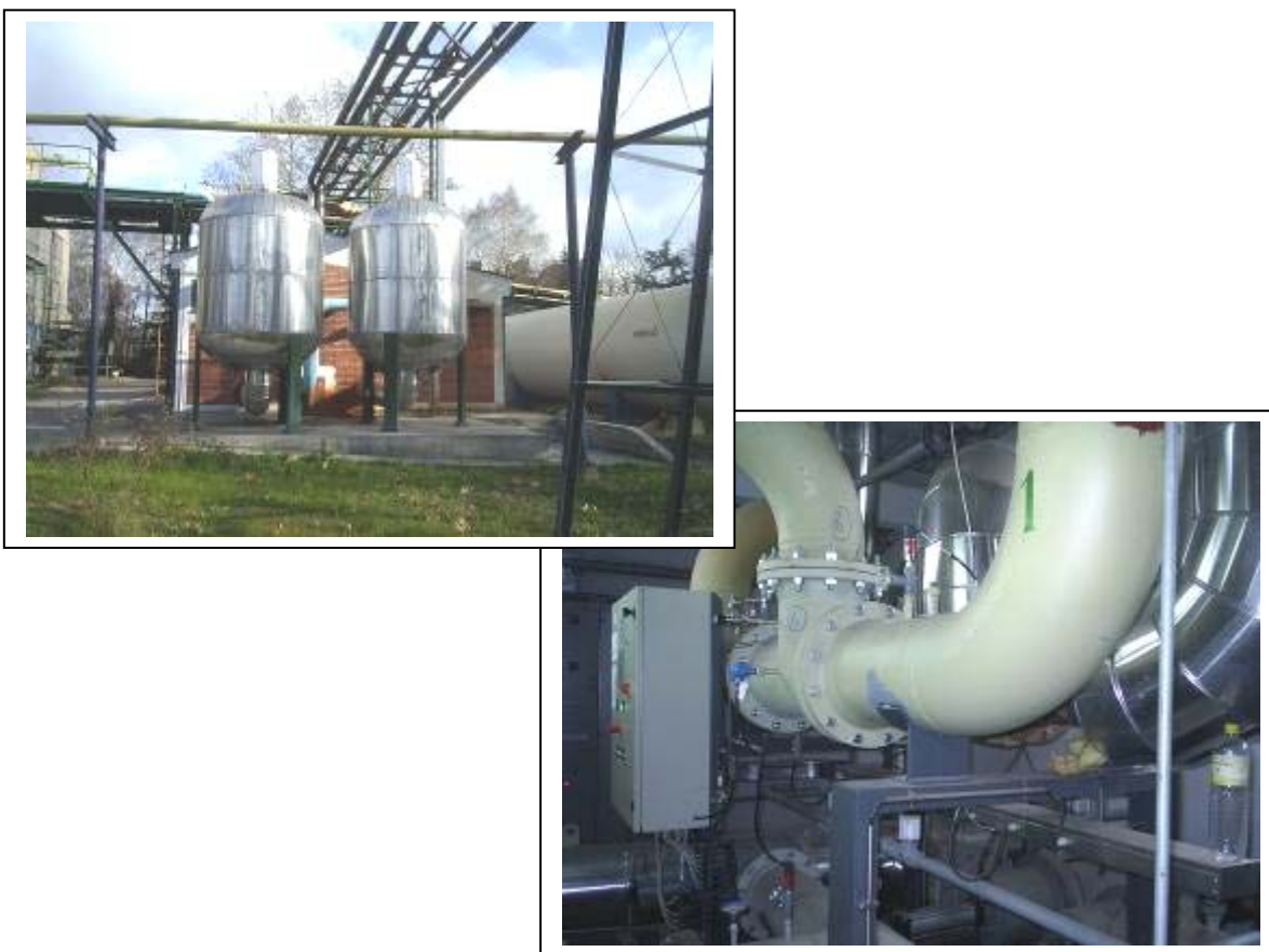
Слика бр.V-8 и бр.V-9: Постојка за сушење на компримиран воздух
