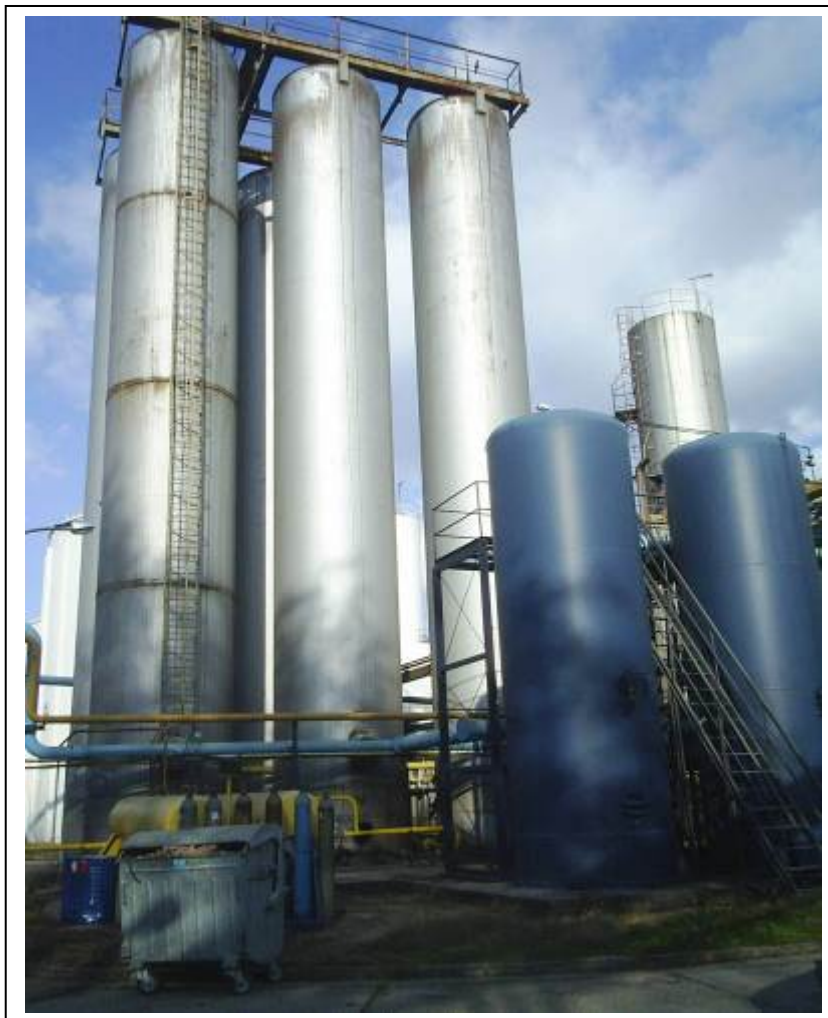
Слика бр. V-5 : Резервоари за O_2 и компримиран воздух
