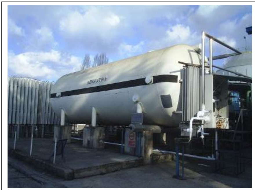
Слика бр.V-3 : Резервоар за N 2
