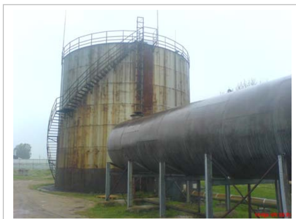
Слика II.2.3.3-1: Резервоари од котлара 1 и 2
